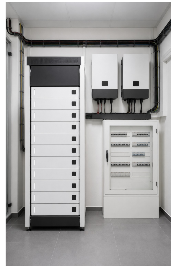
Speicher, Wechselrichter, Verteilung – das Herzstück des Lastmanagements
