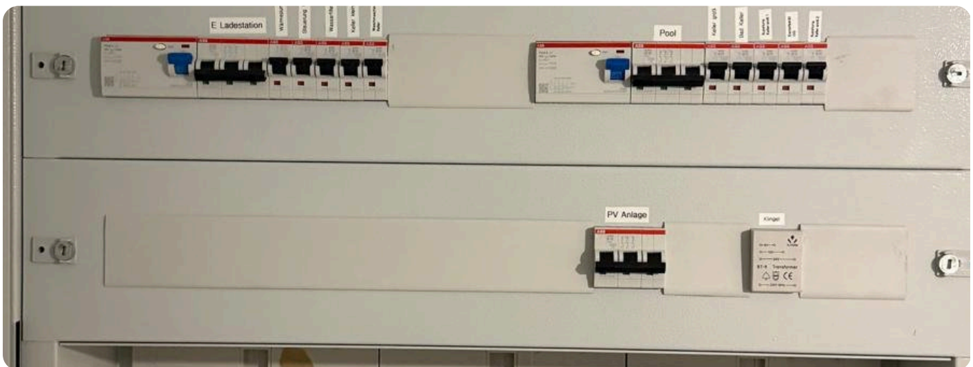
VERTEILER EINES NEUBAUS • JEDER STROMKREIS BESCHRIFTET • FI-GRUPPEN • RESERVEPLÄTZE • PV UND LADESTATION VORBEREITET
